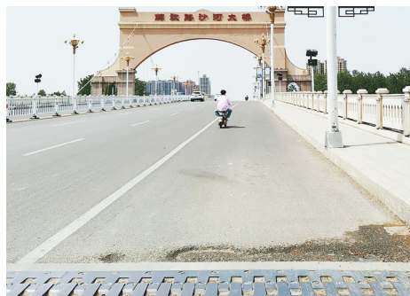
解放路沙河大桥两侧非机动车道有三处（东边一处、西边两处）坑洼。
