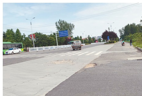
牡丹江路与中山路交叉口道路破损。
