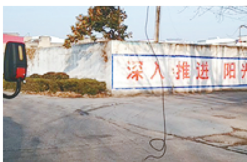
渭河路与银鸽大道交叉口向东310米路中间，线缆低垂。
