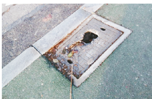
柳江路与嵩山南路交叉口向东5米路北人行道上，井盖破损。
