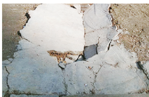
淞江路与新川路交叉口向西60米路南，人行道塌陷。
